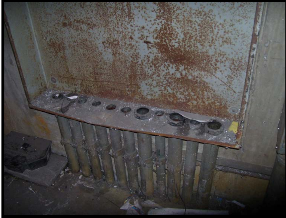
Location #31 – Open conduit
